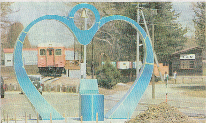
幸福駅に設置工事中のハート形モニュメント。現在は青色の保護シートで覆われている
